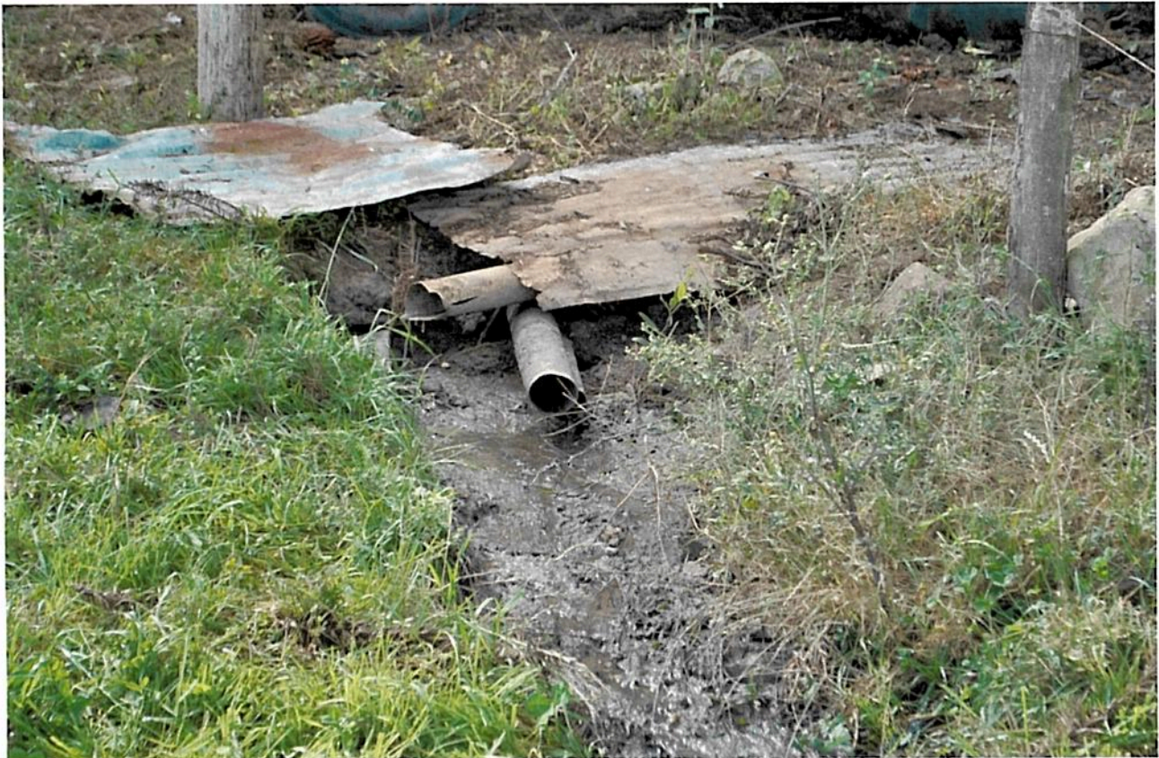
Situação encontrada do esgotamento sanitário – Produtor rural: Renan Alves Localidade: São Francisco – Criúva
