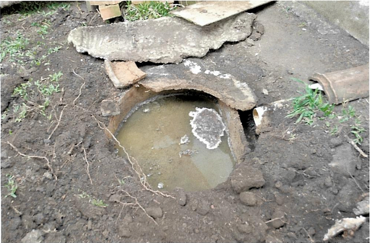
Situação encontrada – esgotamento sanitário – Produtor rural: Alcione Leitão Localidade: Vila Seca
