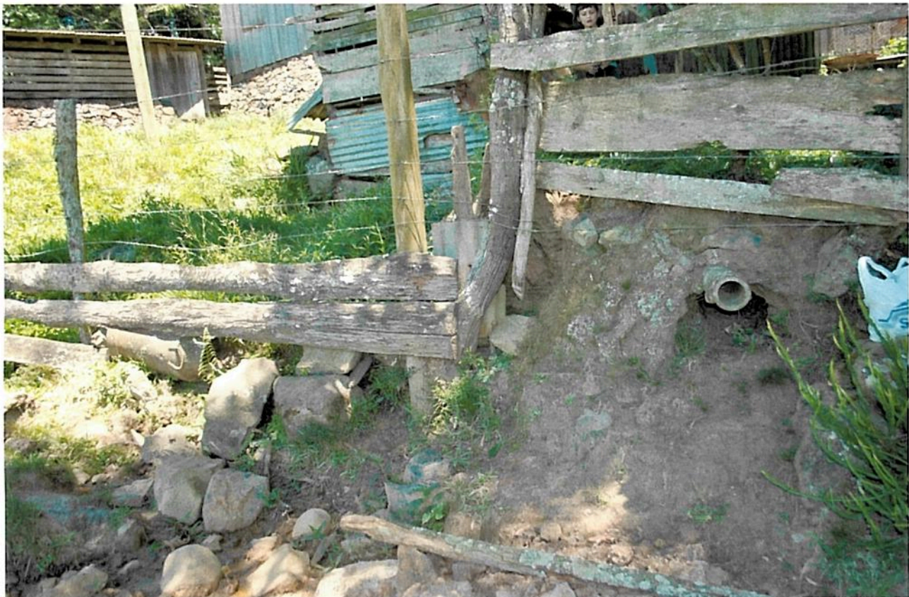
Situação encontrada – esgotamento sanitário – Produtor rural: Alencar Machado Localidade: São Francisco - Criúva
