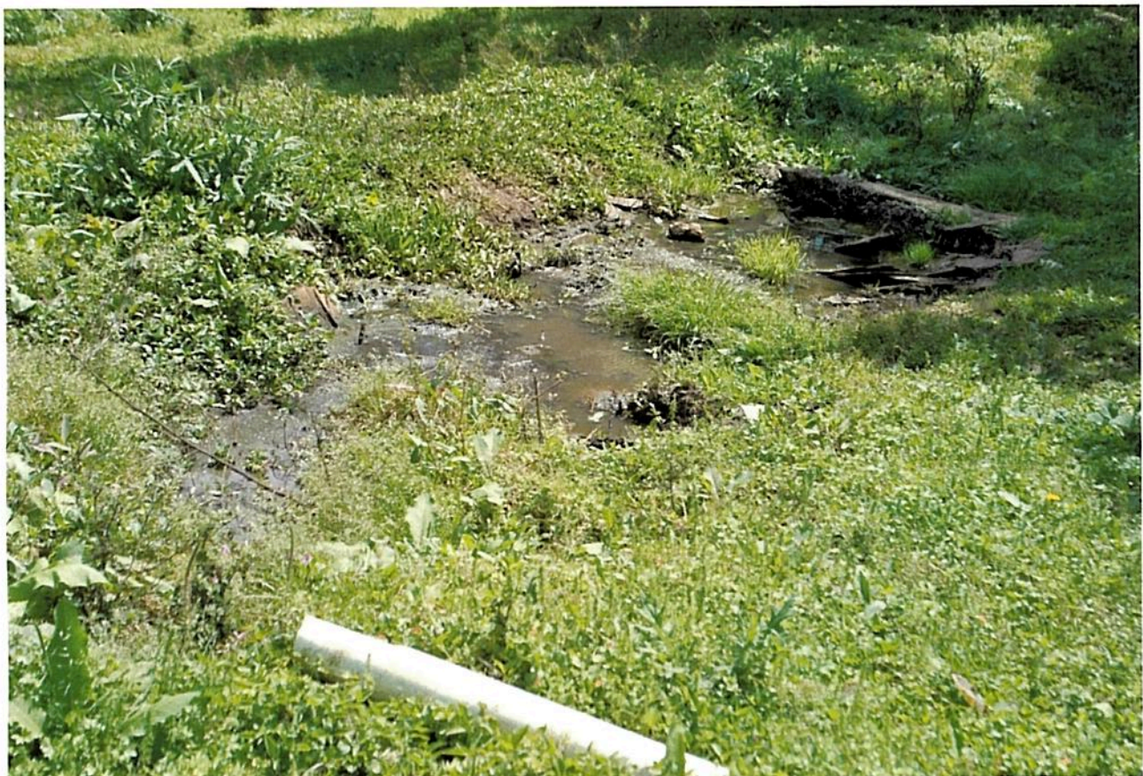
Situação encontrada – esgotamento sanitário – Produtor rural: José Leitão Localidade: Vila Seca
