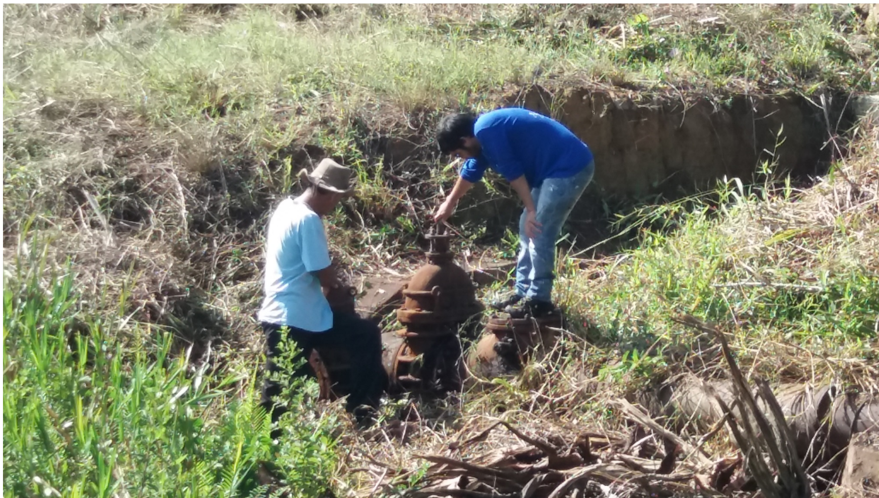
Descarga de fundo do açude Morrinhos (existe ligação à adutora por gravidade)
