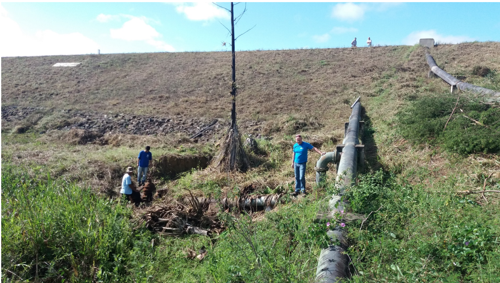
Descarga de fundo do açude Morrinhos (existe ligação à adutora por gravidade)
