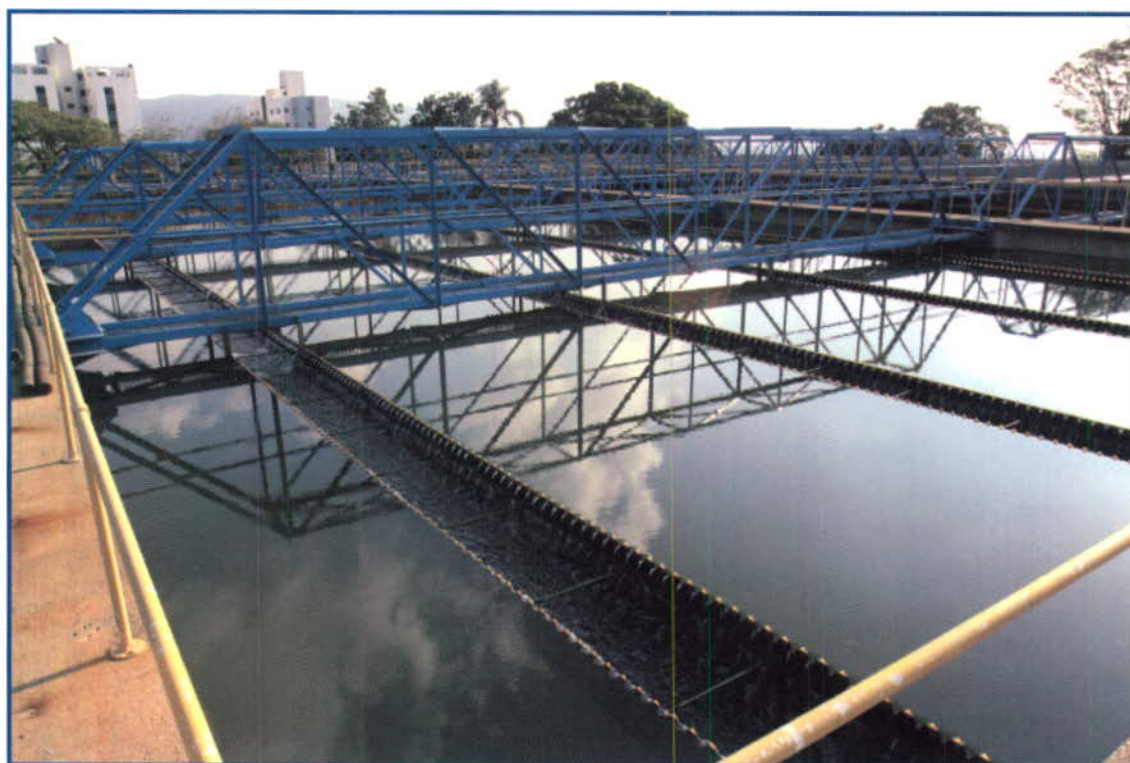
■ Figura 23 – Tratamento de água – ETA Jundiaí, em Jundiaí (SP) – Foto: Tomas May
