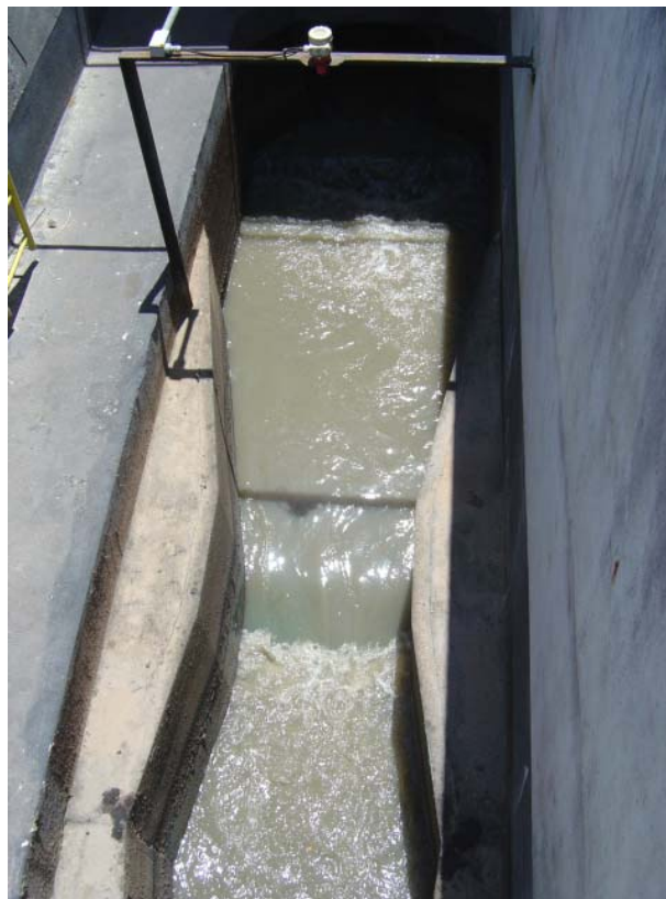
Figura 05 - Calha Parshall instalada na entrada do esgoto bruto na ETE Estoril.
