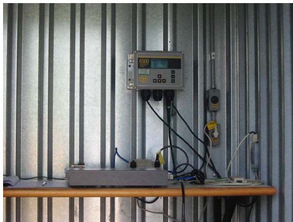
Figura 09 – DAE Valinhos: sistema de monitoramento de qualidade de água próximo ao ponto de captação do Rio Atibaia
