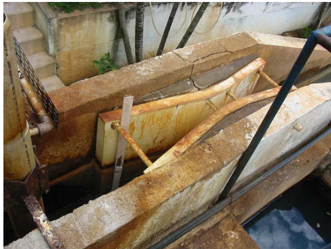
Figura 08 – SAAE Amparo: sistema de medição manual, utilizando a calha Parshall – leitura de nível
