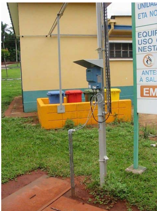
Figura 06 – Rhodia: Sistema de medição em teste na entrada da ETA (captação)
