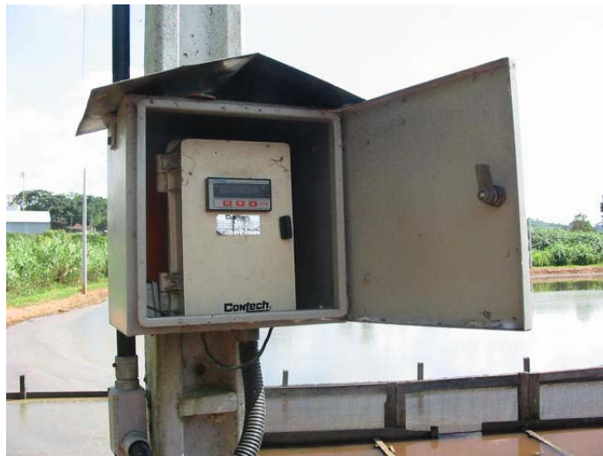
Figura 12 – Sensor eletrônico de medição quantitativa de água na saída da ETDI
