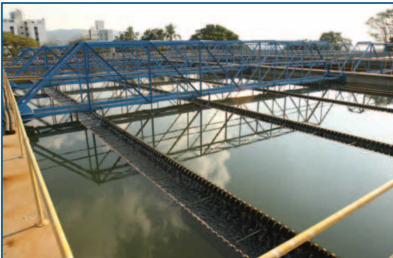
Figura 23 – Tratamento de água – ETA Jundiá, em Jundiá (SP) – Foto: Tomas May
