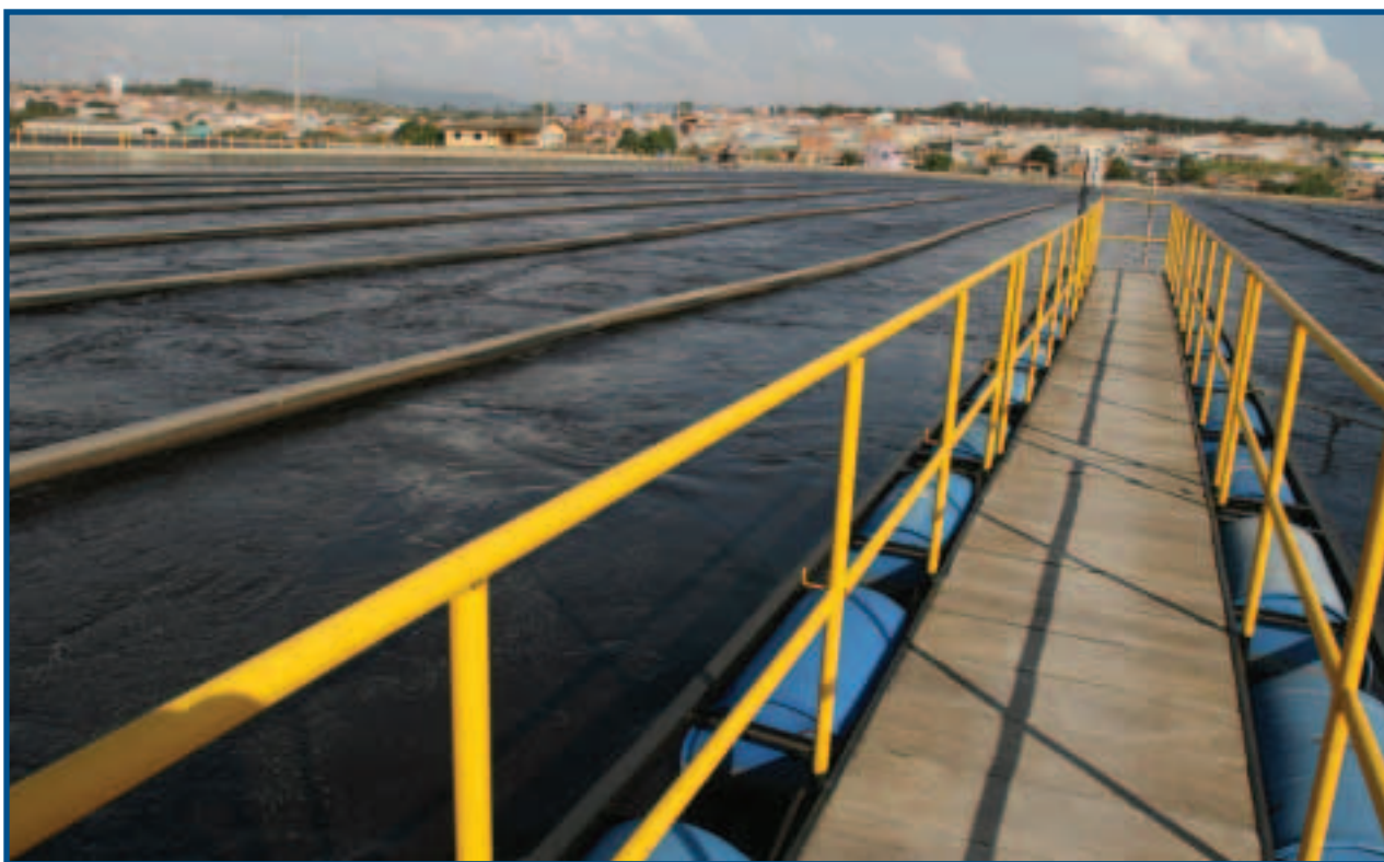
■ Figura 21 – Tratamento de esgoto – ETE Jundiá, em Jundiá (SP) – Foto: Tomas May
