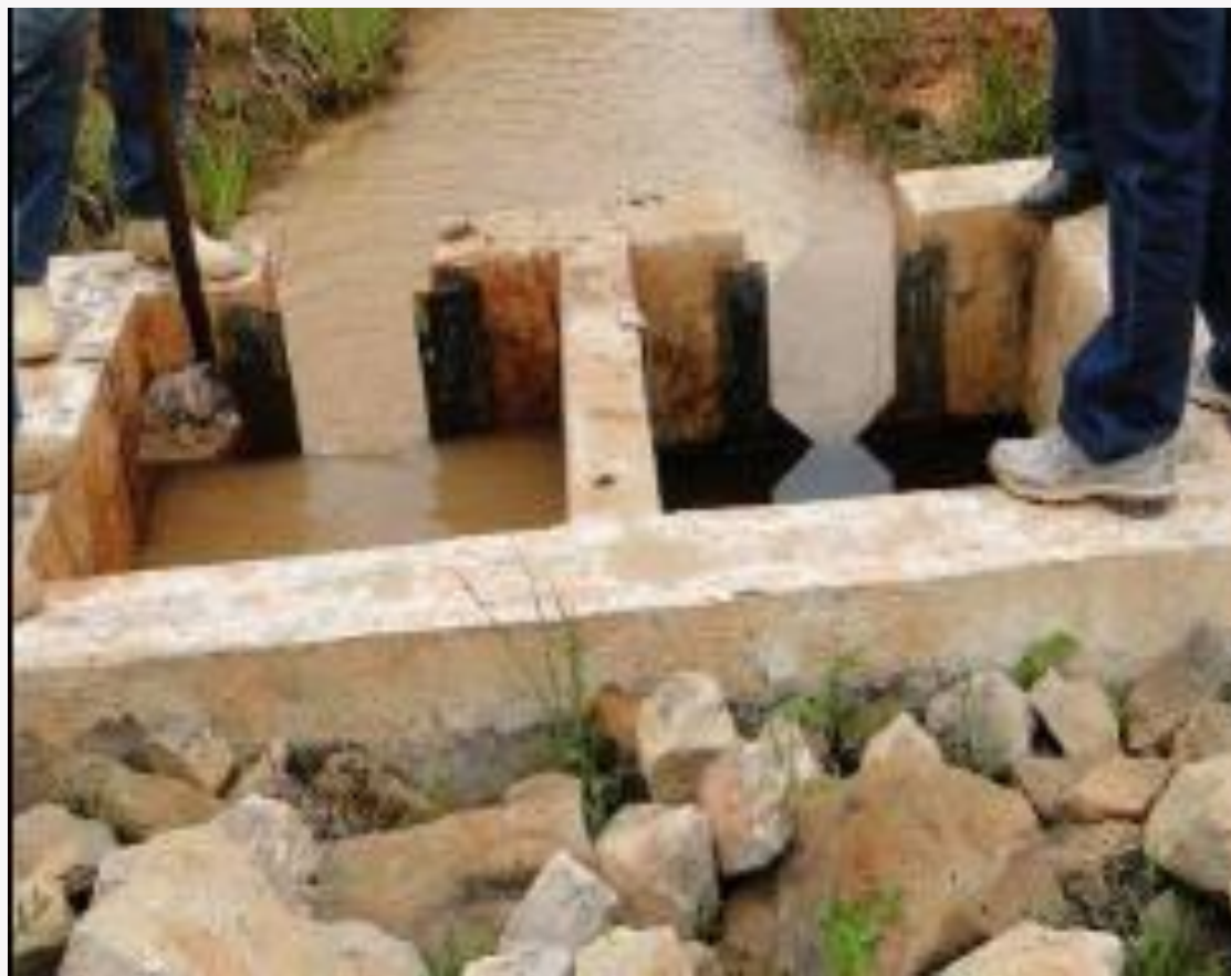
Percolação pela ombreira esquerda
