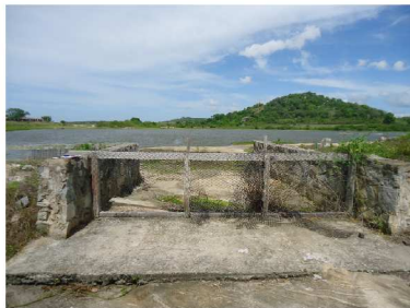
Obstrução propositada (muito perigosa)
