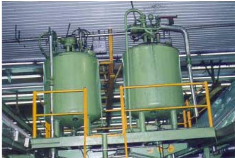
Figura 4 - Tanques de armazenagem de goma sem interligação.
